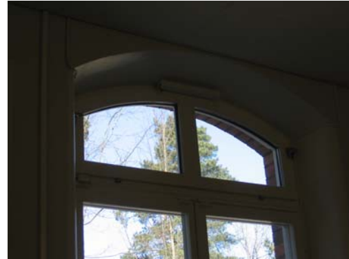
Resatd gård: Fönster som används för ventilation.
